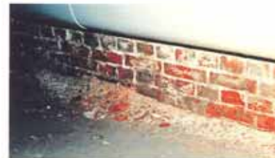
Die Temperatur der Versorgungsrohrleitungen verstärkte den Feuchteintrag
