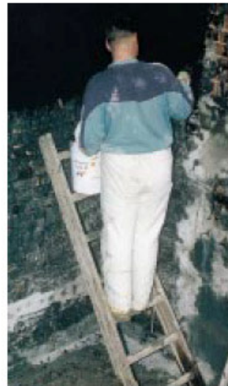
Auftragen eines Bitumenvoranstriches: Er wurde frisch abgesandet, um als Haftbrücke für die überbrückende Bitumendickbeschichtung zu dienen.
