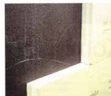
Elastische Abdichtung aus kunststoffmodifizierter Bitumendickbeschichtung zweilagig. Perimeterdämmung aus extrudierter Hartschaumdämmung. Verklebung mit Dickbeschichtung. Zur Herstellung fester Fundamentaufflagen die Platten am Kehlenaufsatz abschrägen
